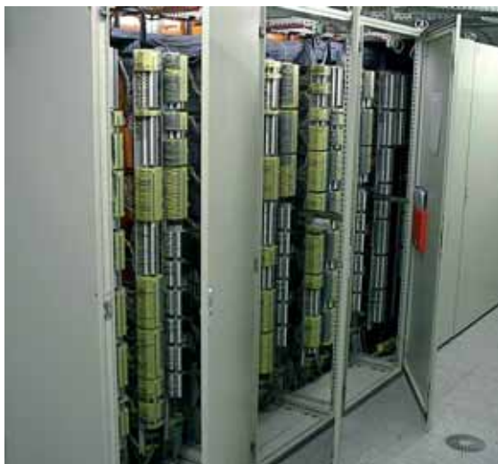
图9.4.7 电涌保护器DCO ME 24，安装在开关柜中，用于整个测量和控制系统的保护
