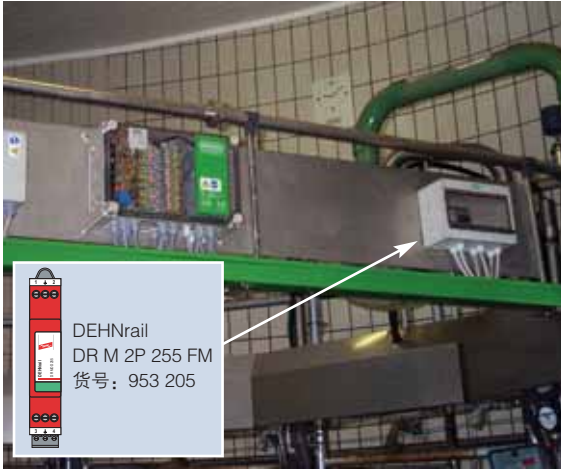
图9.6.5 挤奶系统的电气控制箱
