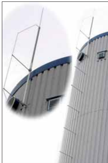
图9.3.7 使用隔离式接闪装置保护由金属板制成的发酵桶（来源：Büro für Technik, Hösbach）
