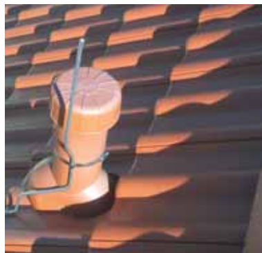
图5.1.2.3 为通风管加装的接闪装置
