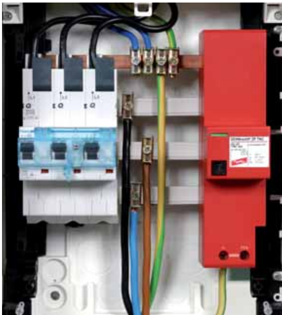
图6.2.2 直接接在母线排上，安装在电表控制柜的复合型电涌保护器 DEHNventil ZP
