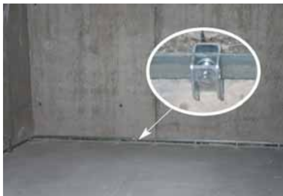
图7.4.2 机房中的环形等电位连接排
