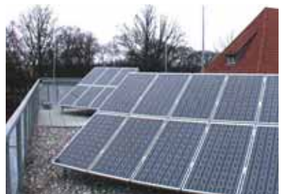
图5.1.8.6 用于光伏设备的隔离接闪装置
