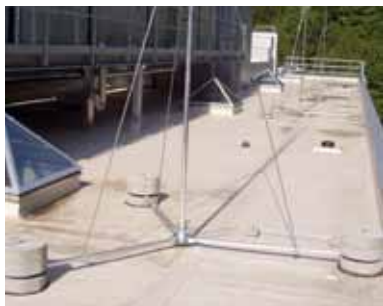
图5.1.8.7 屋顶上的隔离接闪装置
