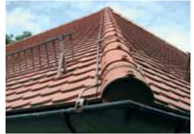
图5.2.2.1.3 接闪装置，连接在屋顶排水管道上
